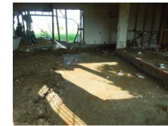
ガレキ撤去後の内部
