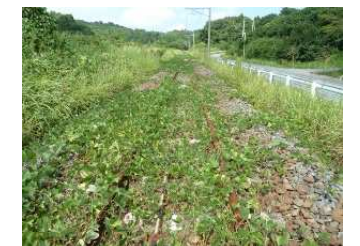
錆びた常磐線の線路
