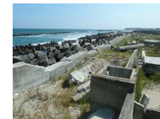
堤防も破壊されている
